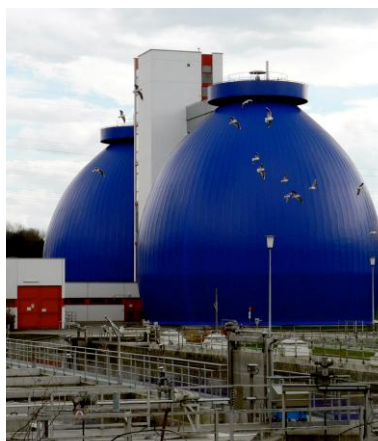
FIGUUR 3.9 VOORBEELD SLIBGISTINGSINSTALLATIE IN DUITSLAND (KLÄRANLAGE LANGEWIESE, ORTSCHAFT ESCHACH, STADT RAVENSBURG [3])
